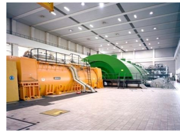
Bildquelle: EON Kernkraft GmbH
